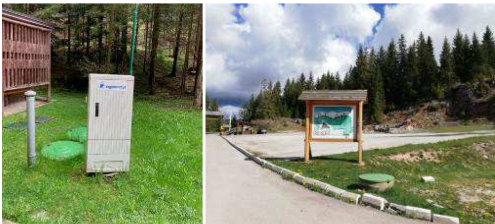
Slika 54: Lokacija bioprečištača (lijevo) i separatora ulja (desno)
