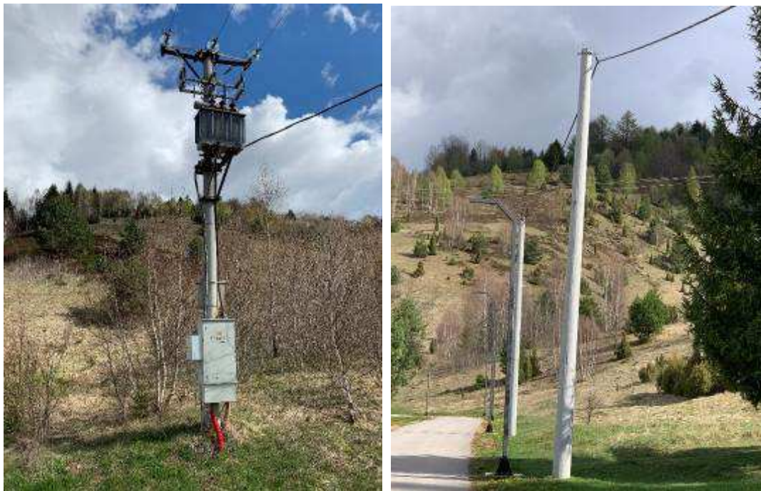
Slika 38: Energetska infrastruktura ZP Bijambare
